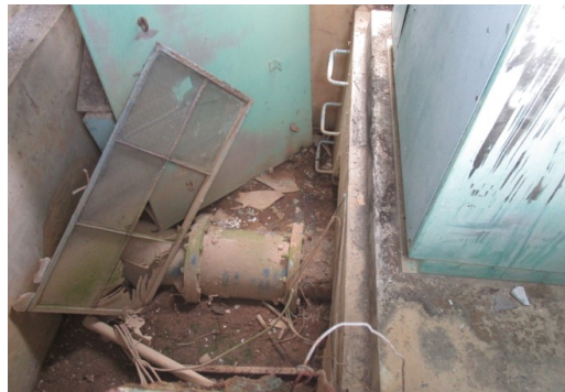
量水器室內部及40公分水管
