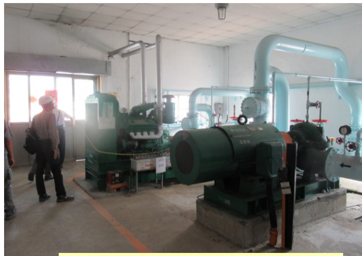
揚水第一泵房內的新式抽水機
