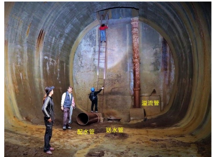
配水池前側的配水管、送水管、溢流管
