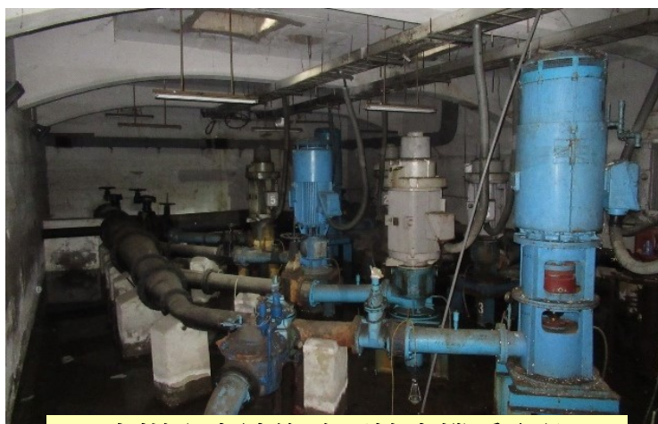
大樹取水站的地下抽水機房內部
