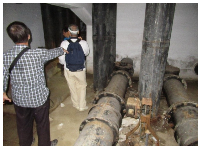
量水所地下室的昭和十六年鑄鐵管
